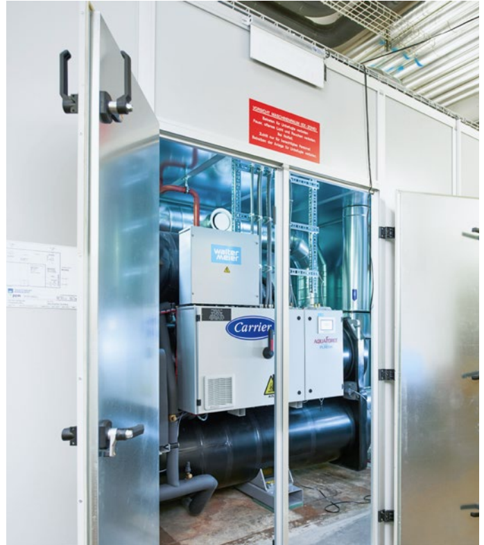
Die Wärmepumpe im Gehäuse in der Heizzentrale.
